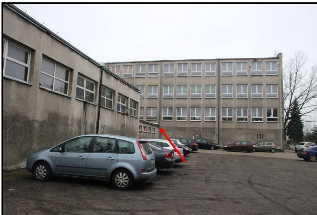
Fotografia 10: Widok na wschodnią elewację sali gimnastycznej oraz łącznika z zaznaczonymi miejscami gniazdowania ptaków w otworach wentylacyjnych.
