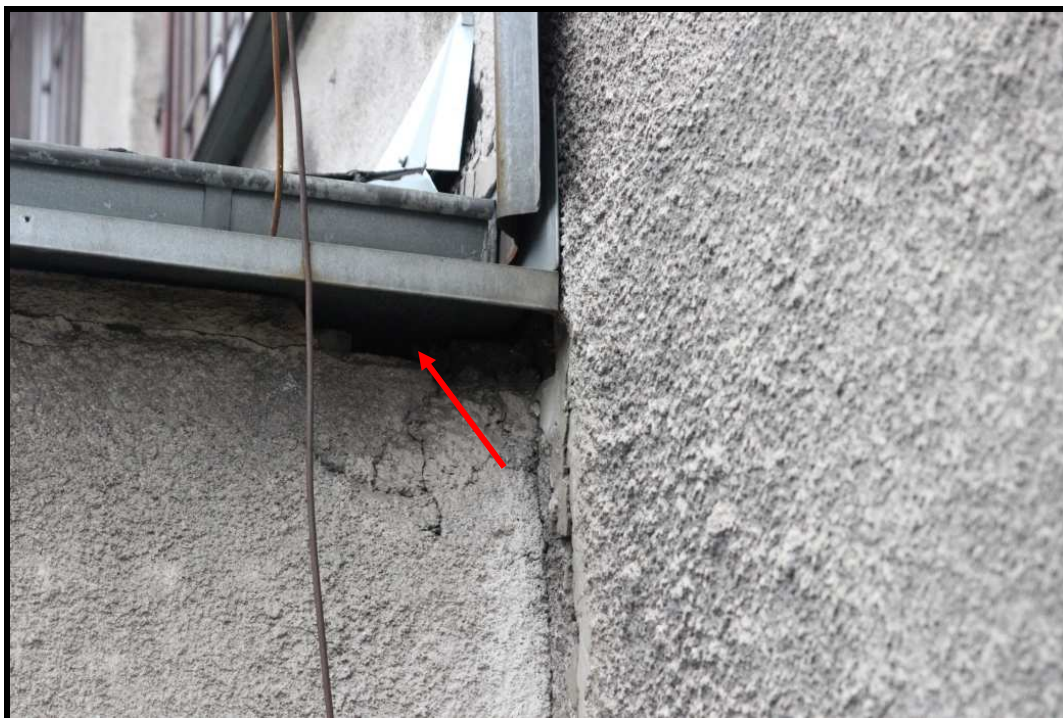
Fotografia 11: Widok na szczelinę pod opierzeniem wschodniej elewacji łącznika z południową elewacją budynku dydaktycznego stanowiącą potencjalne miejsce gniazdowania ptaków.
